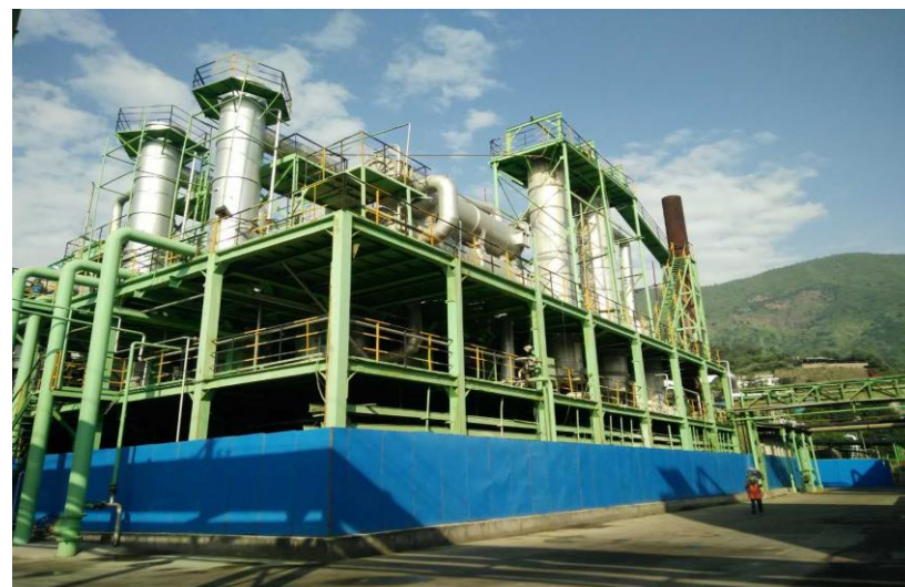
攀枝花钒制品厂废水污泥综合利用生产线
